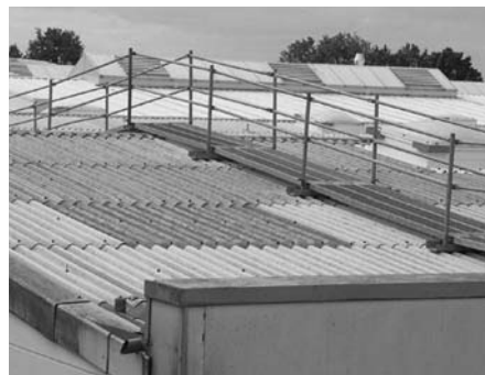
Figura 15: Cobertura resistente al pisar y a las cargas
