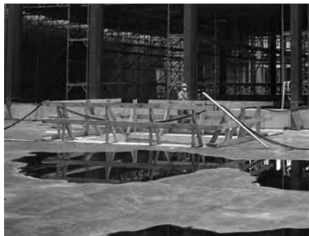
Bild 6: Kanten, Gruben und Böschungen
