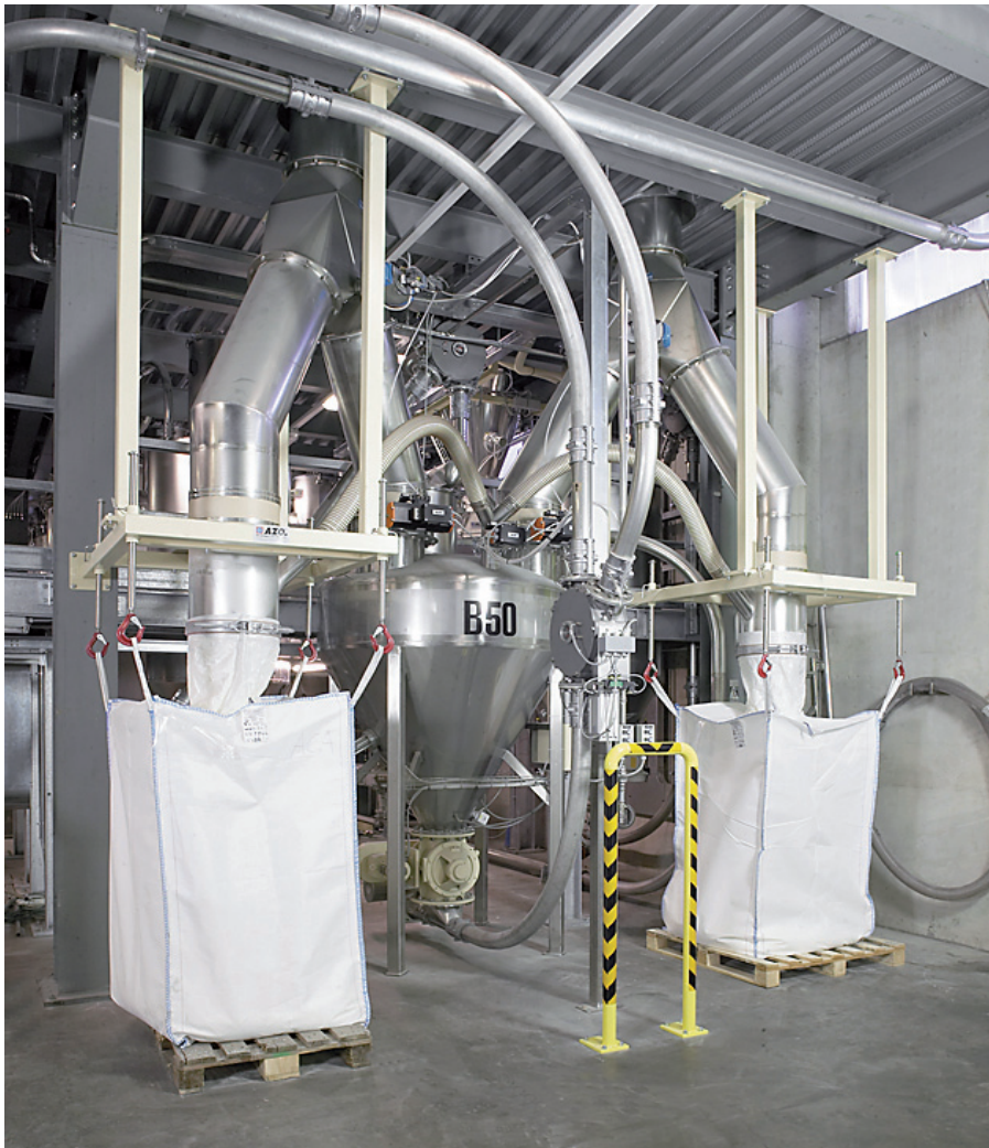
Abbildung 18: FIBC Befüllung (Quelle: AZO® GmbH + Co. KG)
