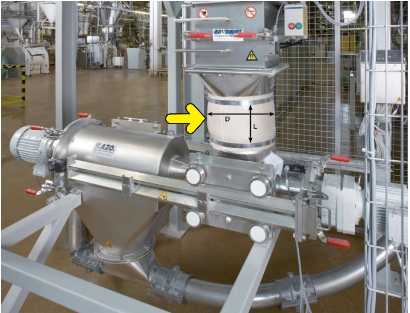
Abbildung 22: Kompensator (Pfeil) zwischen Magnetabscheider und Siebmaschine (Quelle: AZO ® GmbH + Co. KG)
