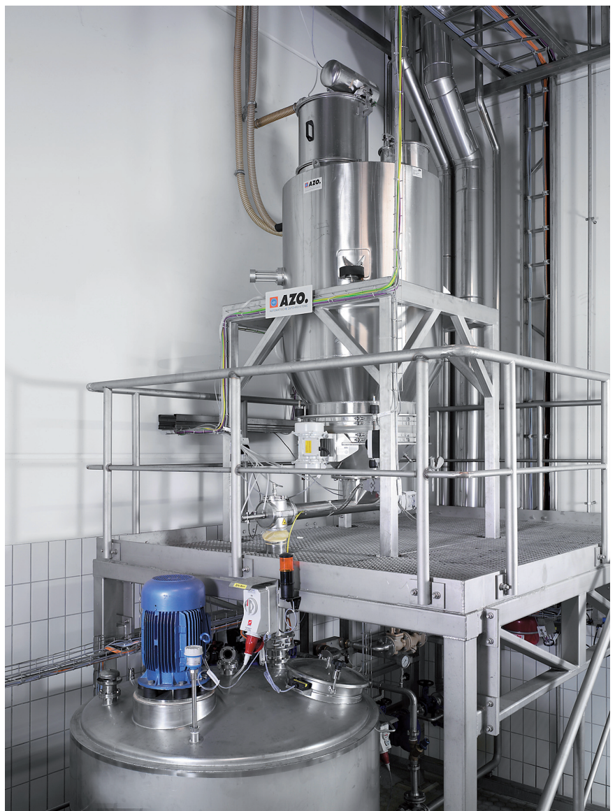
Abbildung 21: Empfangsbehälter einer pneumatischen För- derung. Von dort wird das Produkt mit einem Schneckenförderer dem Rührbehälter zugeführt (Quelle: AZO® GmbH + Co. KG)
