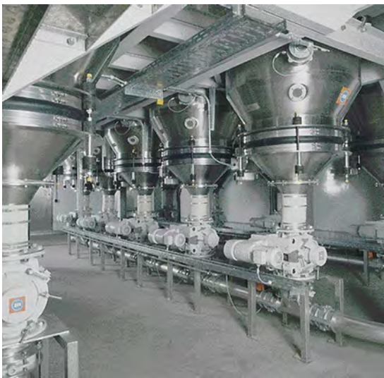
Bild 31: Siloreihe mit Austragung in pneumatische Förderleitungen mittels Zellenradschleuse (AZO GmbH + Co. KG)
