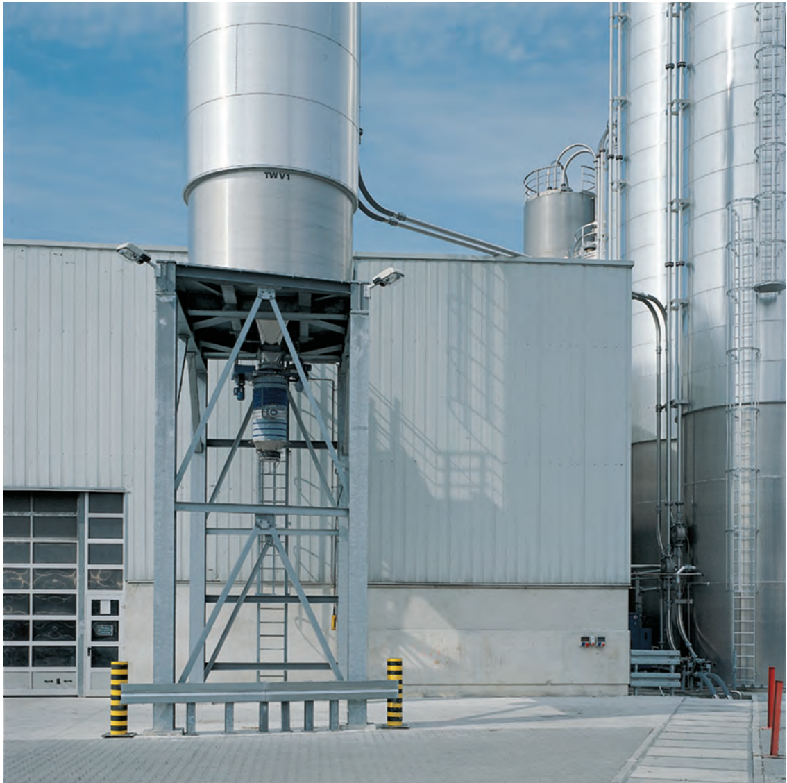
Bild 2: Lagersilo mit Befüllvorrichtung für Silofahrzeuge (AZO GmbH + Co. KG)
