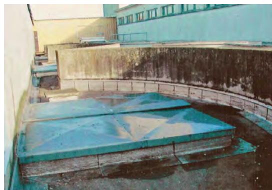
Bild 36: Silogebäude aus Stahlbeton ohne Aspiration, Explosionsdruckentlastung in den Außenbereich des Silogebäudes geführt (Prof. Siegfried Radandt)
