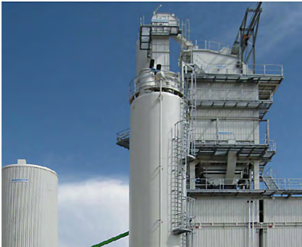
Bild 3: Außensilo mit verfahrenstechnischer Prozessanlage (AZO GmbH + Co. KG)
