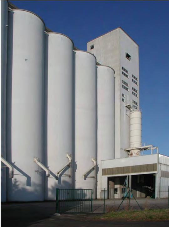
Bild 37: Silos mit Maschinengebäude und Druckentlastungsflächen (Prof. Siegfried Radandt)
