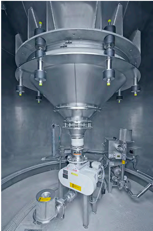
Bild 32: Siloaustragung mit Vibrationsboden und Zellenradschleuse (AZO GmbH + Co. KG)
