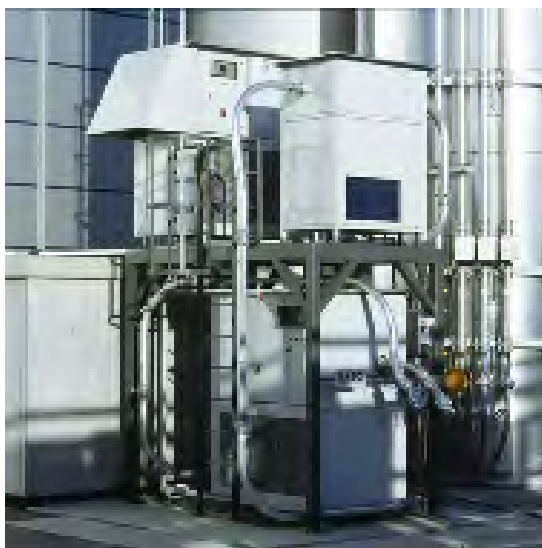
Bild 14: Stationäres Gebläse mit integrierter Funkensperre und nachgeschaltetem Kühler zur Aufbereitung der Förderluft. (AZO GmbH + Co. KG)
