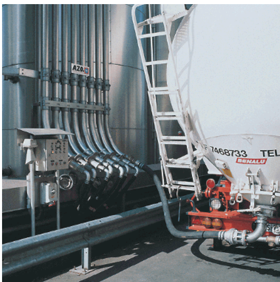
Bild 12 : Silofahrzeug angeschlossen an Befüllleitungen der Lagersilos. (AZO GmbH + Co. KG)
