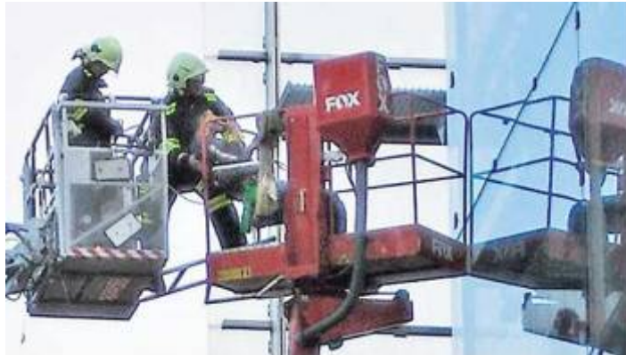
Drama an der Baustelle Feuerwehrleute netzten am Donnerstag vor der Fassade der Baustelle ein Netz aus Sicherheitsnetzen, das sich nur noch mit Mühe in seinen Köben festhalten konnte. Zuvor hatte ein Lastwagen den Hubwagen der Baustelle in die Höhe geschleudert und in Schwingungen versetzt. Der Kollege des Hubwagenführers, ein 46-jähriger Familienvater aus Rommelspurg, stürzte 26 Meter in die Tiefe und starb. Seite 10
